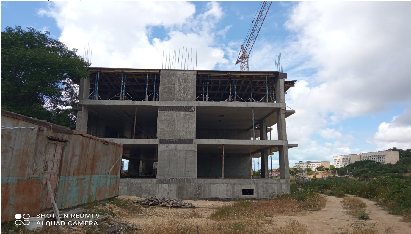
Фото В.1 фасад здания в осях Е-А
